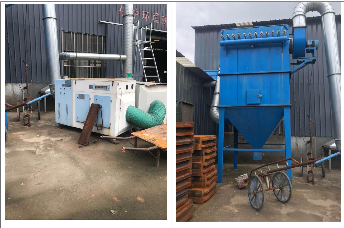
图 5 废气处理设施现场照片
