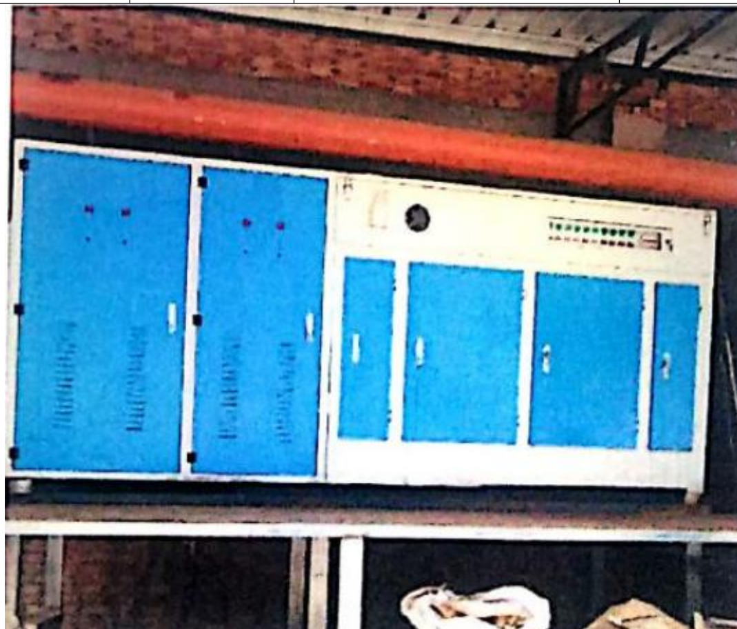
静电油雾净化器+UV 光解/低温等离子一体化装置
