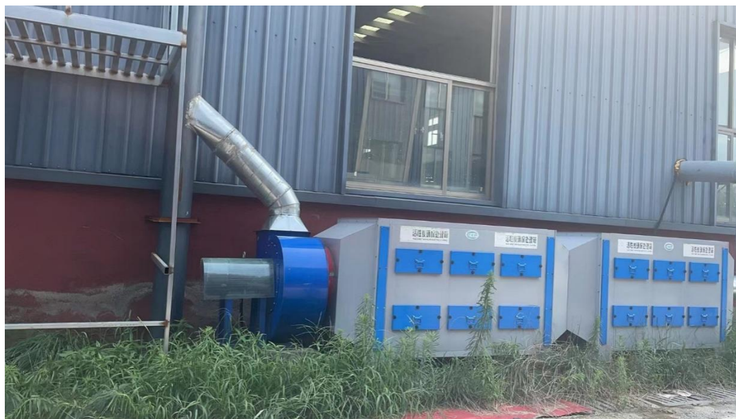
图 3-1 现场废气处理设施
