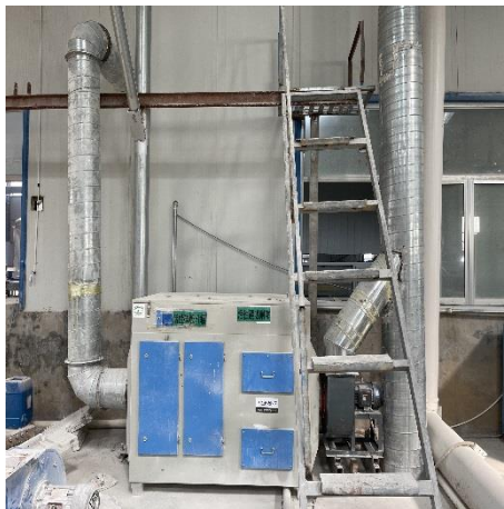
图 3-1 现场废气处理设施
