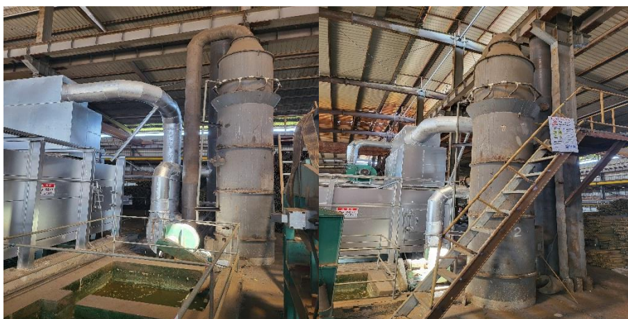
图 3-1 现场废气处理设施
