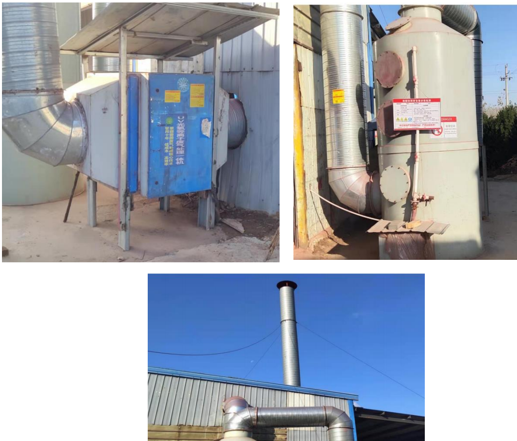
图 3-1 现场废气处理设施
