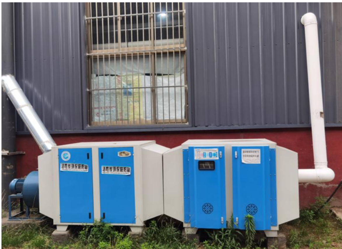
图 3-1 现场废气处理设施
