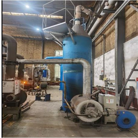
图 3-1 现场废气处理设施
