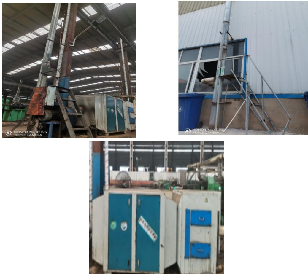
图 3-1 现场废气处理设施
