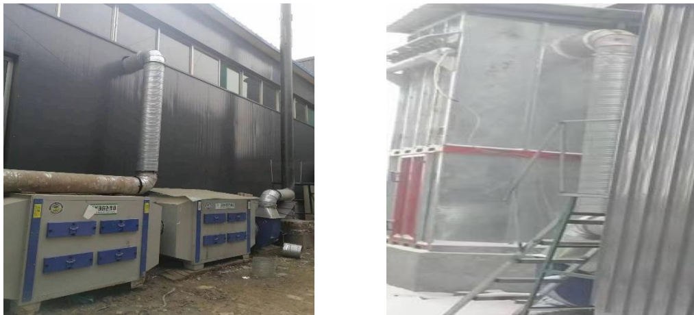
图 3-1 现场废气处理设施
