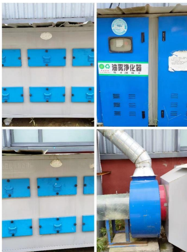
图 3-1 现场废气处理设施
