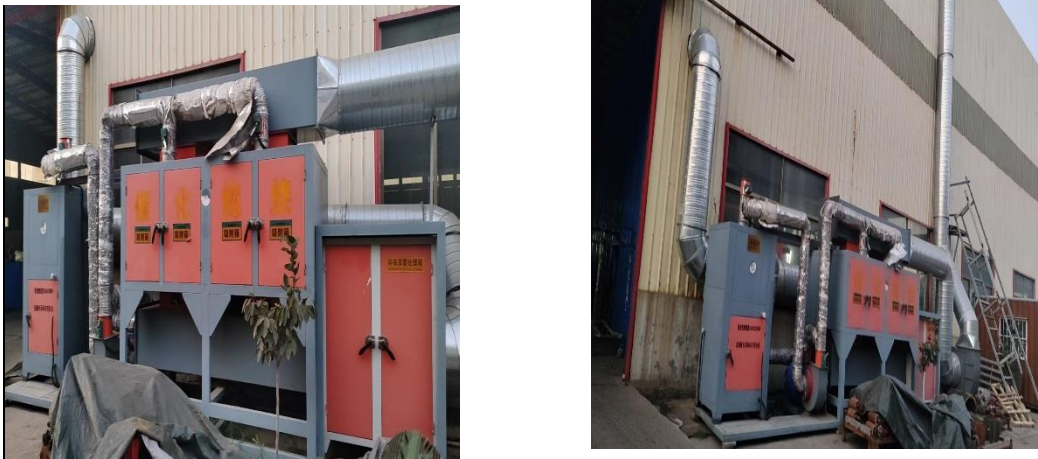
图 3-1 现场废气处理设施
