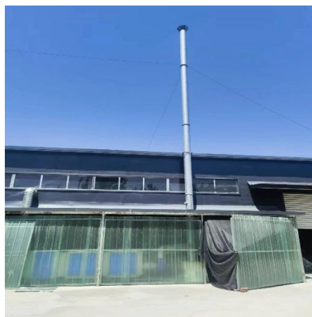
图 3-1 现场废气处理设施
