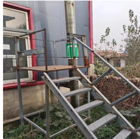
图 3-1 现场废气处理设施
