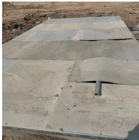
厂区内沉淀池
