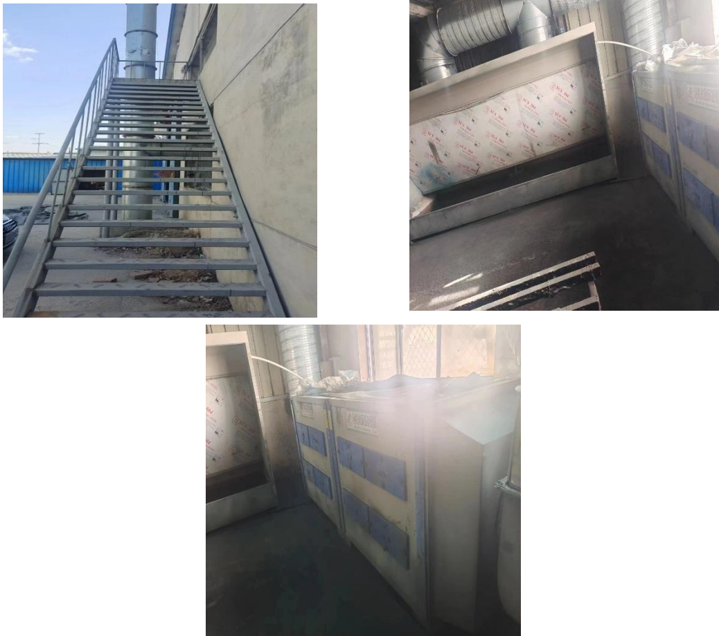
图 3-1 现场废气处理设施
