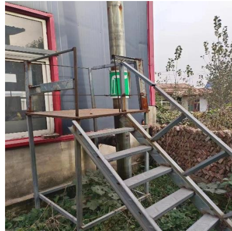
图 3-1 现场废气处理设施
