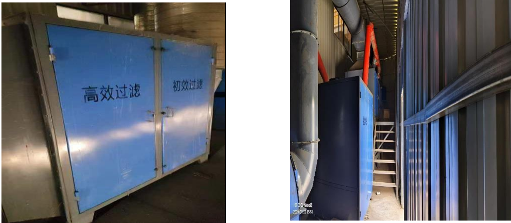
图 3-1 现场废气处理设施
