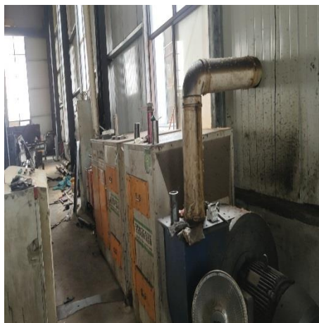
图 3-1 现场废气处理设施
