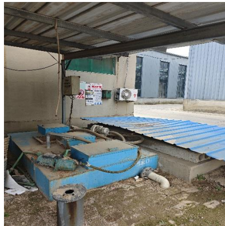
图 3-1 厂区内现有污水处理设施
